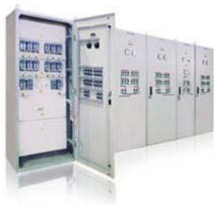
Рис. 6. Щит постоянного тока.
