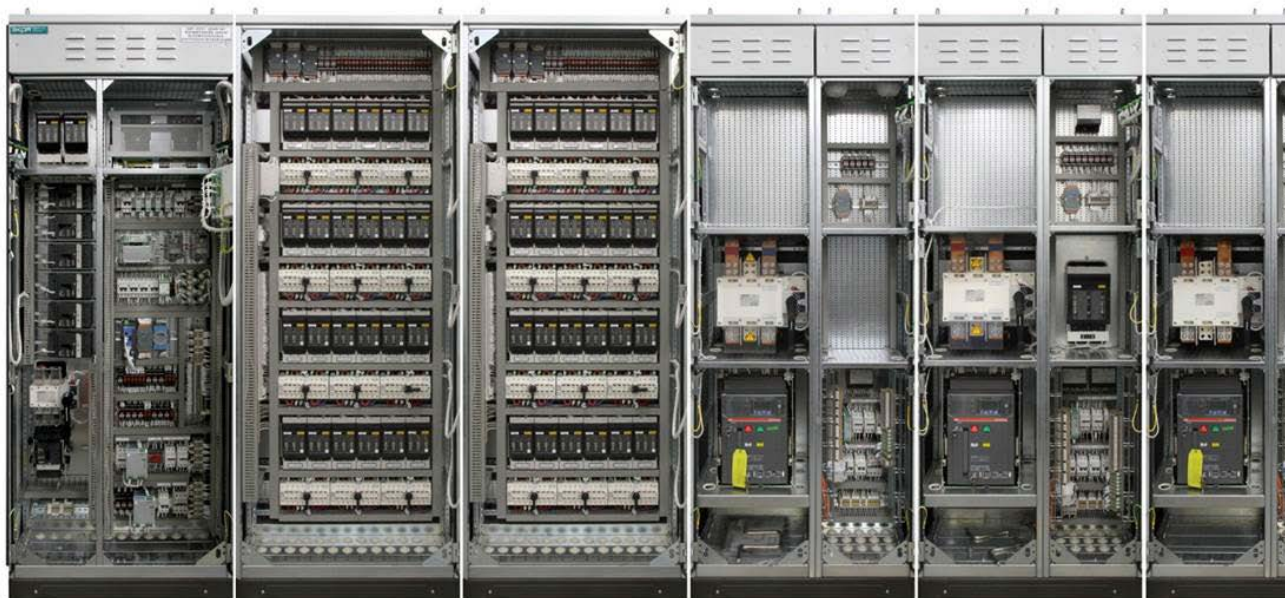
Щит постоянного тока вид без дверей.
